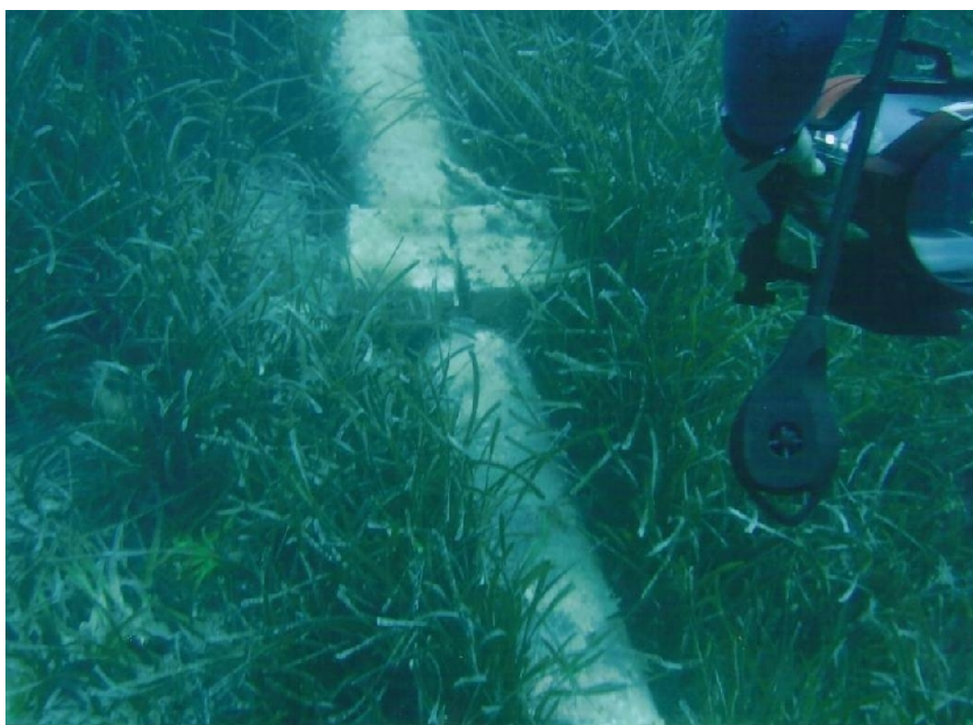
Φωτ. 6 και Φωτ. 7 Υποβρύχια λήψη του υποθαλάσσιου αγωγού υδροδότησης της Καβαλιανής από το δίκτυο της ΕΥΔΑΠ. Όπως φαίνεται παρά την κατασκευή του αγωγού οι ποσειδωνίες ( posidonia oceanica ) έχουν και πάλι αναπτυχθεί.
